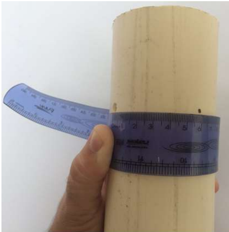
Figura 3.46 – 2ª Marcação para execução da abertura lateral no tubo PVC 75 mm. Fonte: O Autor.
